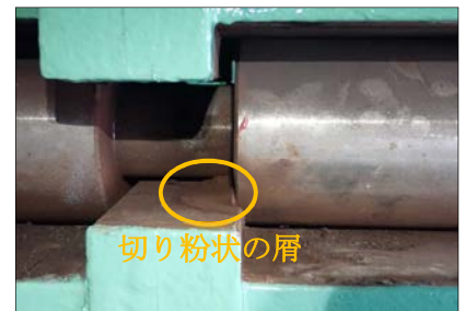
図 2 底板凸部の損傷状況
