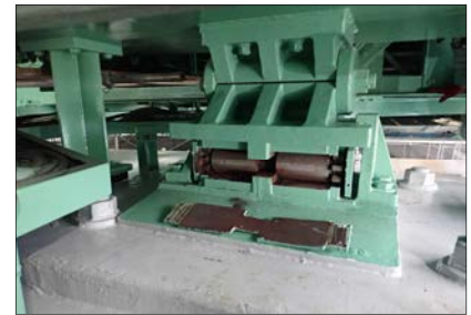
図 1 不具合が確認されたピンローラー支承
