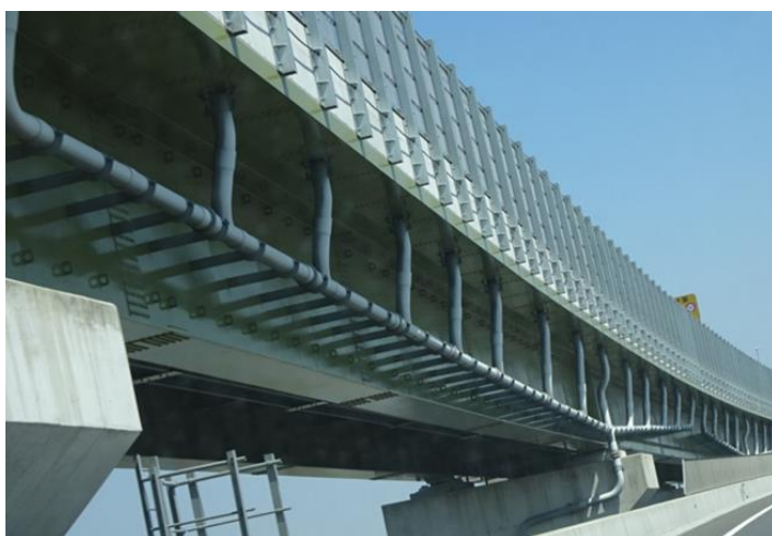
図-2 構造部材と見紛うような立派な排水管は維持管理の障害！
