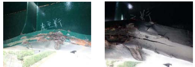
写真-2 左側主桁 写真-3 カバープレートき裂
