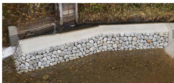
写真-1 実際の設置状況
