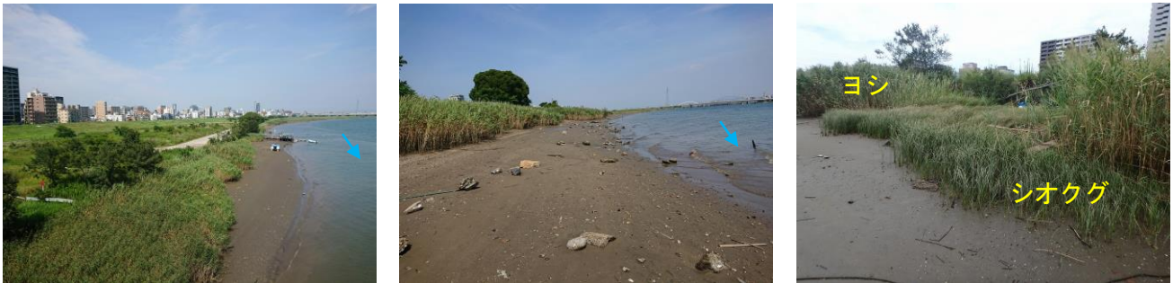
写真-2 低水護岸工事実施箇所の状況（左：全景、中：低水路、右：現地調査で確認されたヨシ・シオクグ）
