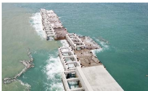
写真-1 被災状況(防波堤起点側から)
