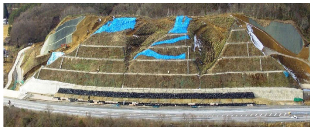
写真-1 被災状況
