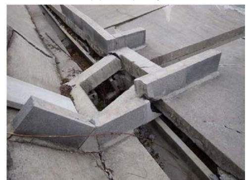
写真-2 損傷状況(集水桝)
