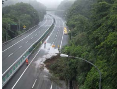
写真-1 被災状況(7月3日)
