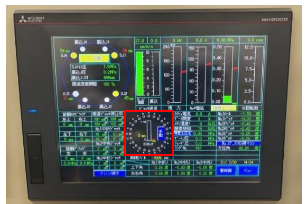
写真1 制御盤モニター 開度表示
