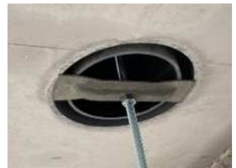
写真-5 無対策桝の下面
