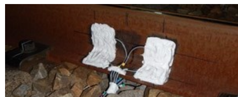
図 2 輪重横圧ゲージの設置状況
