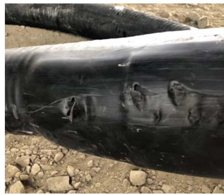
写真-4 ホース損傷
