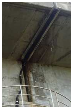
写真-2 B橋変状状況
