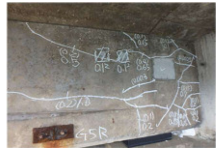
写真3 主桁側面ひびわれ状況
