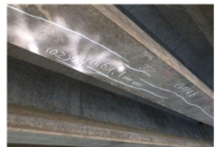
写真4 主桁下面ひびわれ状況(最大幅1.0mm)
