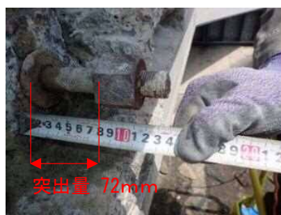
写真-1 突出した PC 鋼棒
