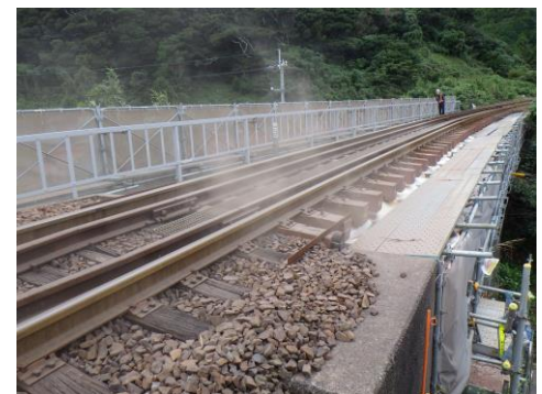
写真-7 粉塵発生状況
