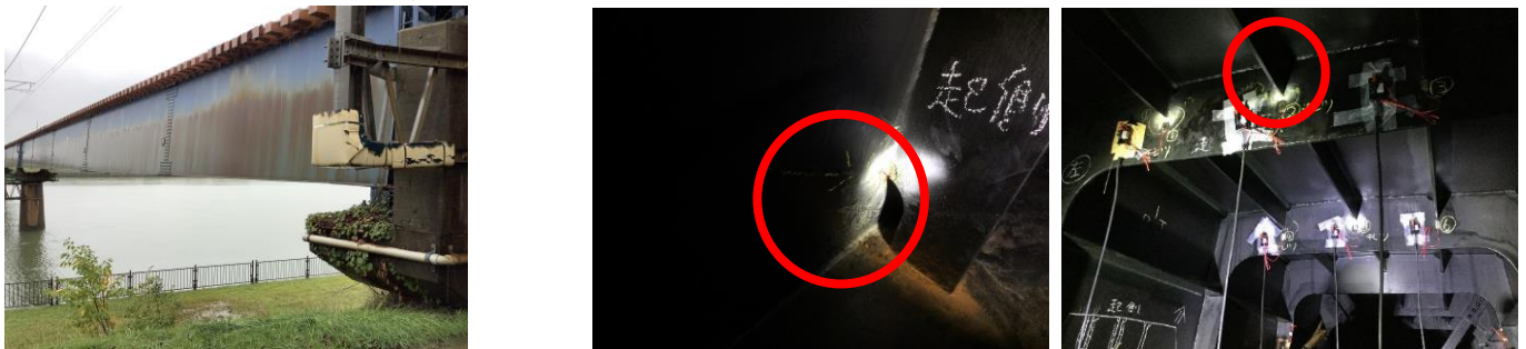
図2 き裂発生箇所（左図：補剛材下端部 右図：縦・横リブ交差部）
