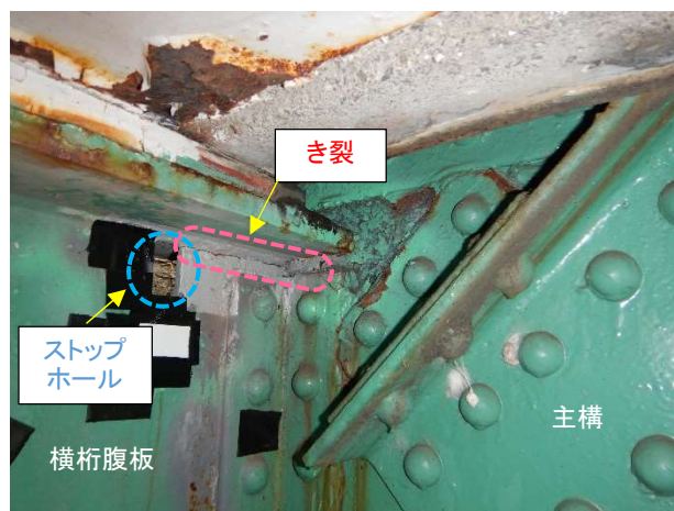
写真-3 端横桁の損傷状況
