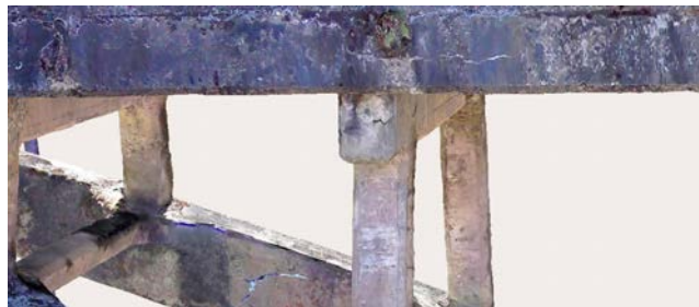
図3 画像取得後の橋梁復元(橋脚のひび割れ)
