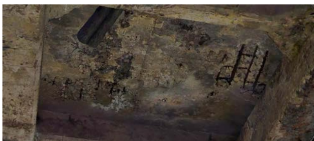
図4 画像取得後の橋梁復元(床版の剥離・鉄筋露出)
