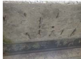
図-4 主桁損傷部
