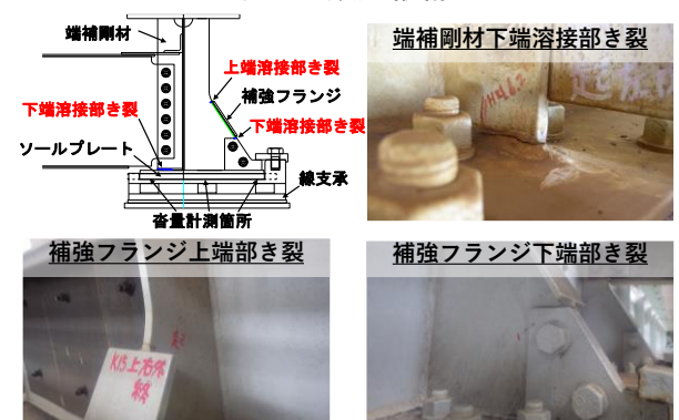
図2 鉄道縦桁に発生している疲労き裂
