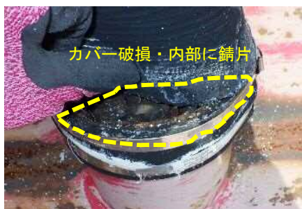
写真-2 ソケット部破損
