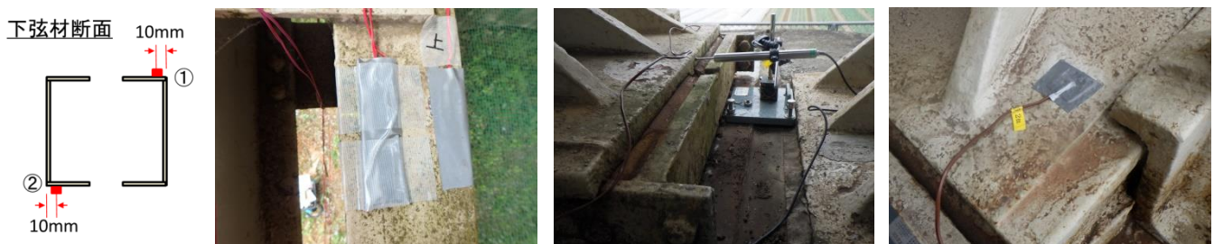
図-1 ひずみゲージ貼付位置、下弦材橋軸方向ひずみ、ローラー沓水平変位、ローラー沓温度の測定状況
