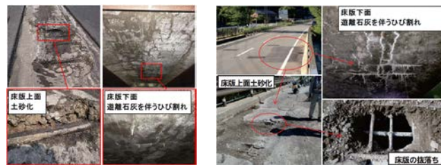
a) 四国の損傷事例 b) 四国外の損傷事例 1)
