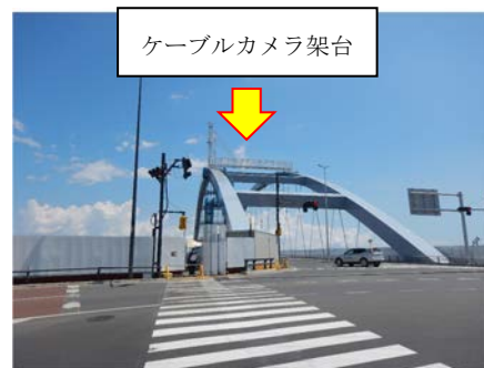
写真-1 ケーブルカメラ架台（設置後）
