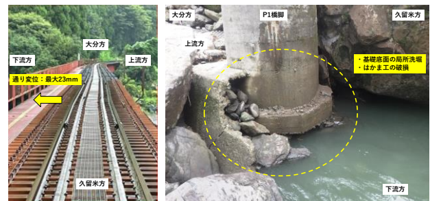
(左) 軌道変位 (右) 洗掘状況
