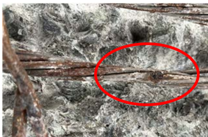
写真6 破断箇所A(素線1本破断)
