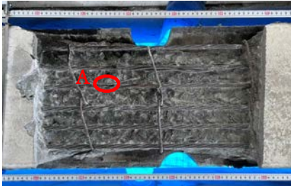
写真5 はつり後桁下面(A:破断箇所)
