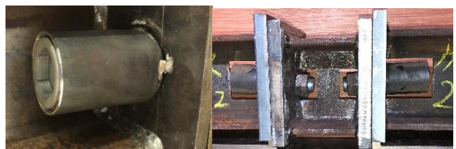
写真 1 QJ の溶接切れ
