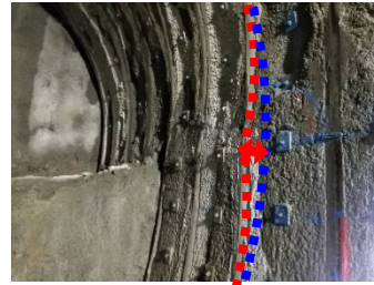
写真-1 トンネル変状状況
