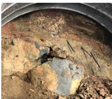
写真-3 切羽崩落状況
