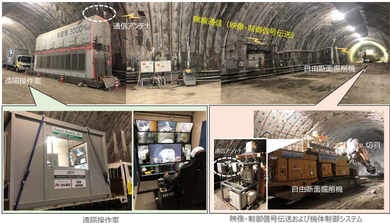
図-1 自由断面掘削機遠隔操作システムの設置状況
