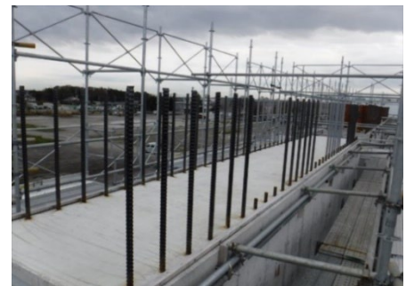
写真-1 鉄筋の暴露状況
