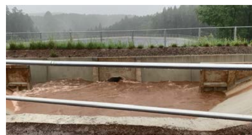
写真-3 豪雨時の排水状況(改善後)
