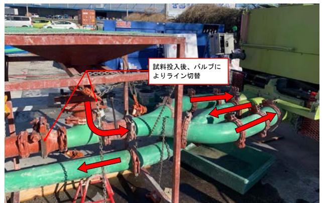
写真-2 簡易圧送試験装置(ポンプ部)
