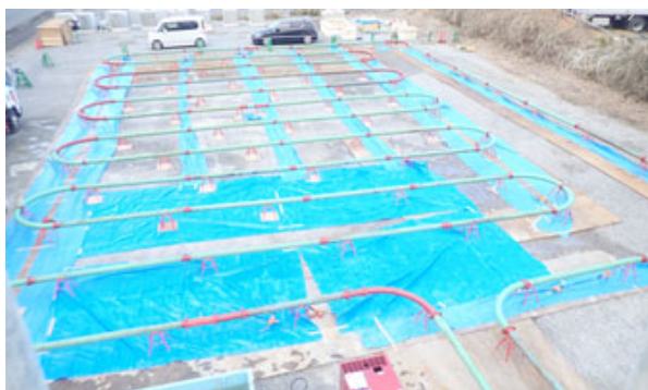
写真-1 配管状況
