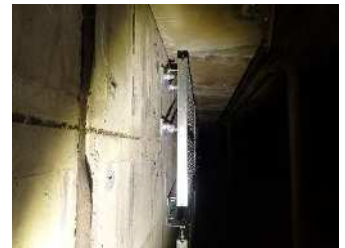
写真-3 吸音板背面離隔状況
