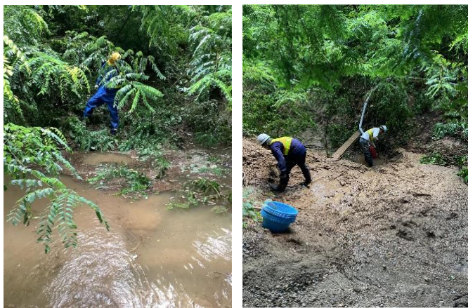
図-1 災害発生時の状況（滞水、土砂堆積）
