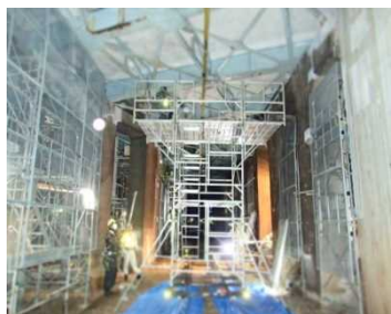
写真-4 軽便トロとローリングタワーによる足場の試験施工
