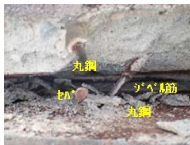
写真-3 床版下面 状況
