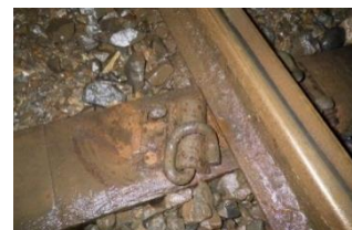
図-2 軌道腐食状況
