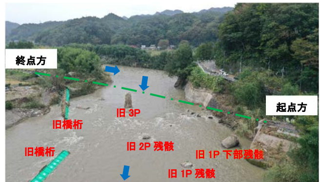
写真-1 押し流された橋脚, 橋桁
