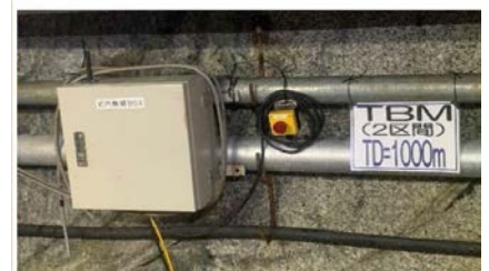
写真-2 無線ボックス
