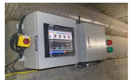
写真-3 監視用モニター
