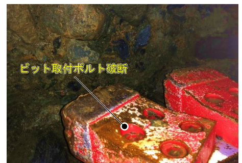
図3 カッタービット脱落状況
