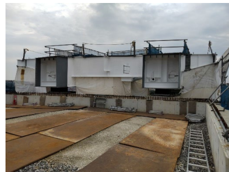
図 5 橋台パラペット未施工状況
