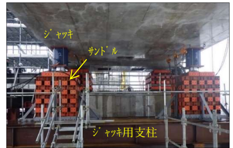
写真-2 ジャッキアップ・ジャッキダウン設備
