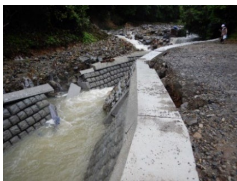
図3 再度被災した普通河川（正司畑川）
