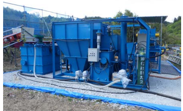
写真-4 濁水処理施設
