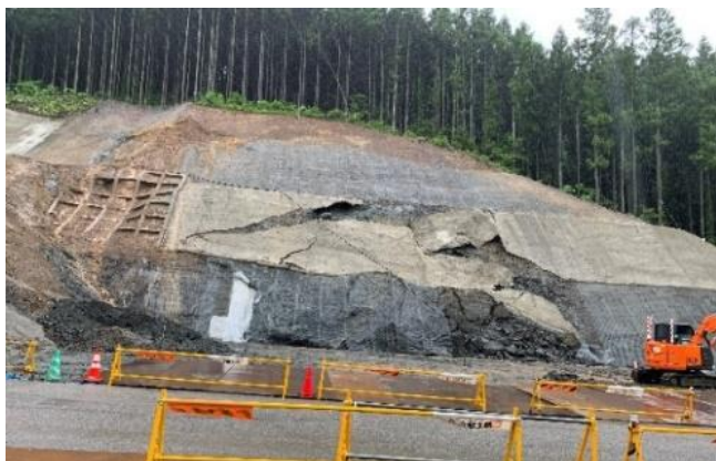
写真—1 法面崩壊直後の状況
