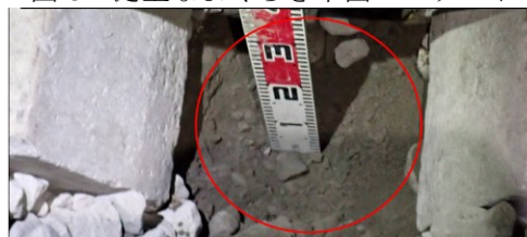
図 9 不健全なまくらぎ下面のバラスト
